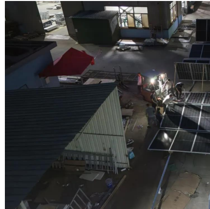
Sistema Solar Fuera de la Red: 5kW con Paneles Paraguay
